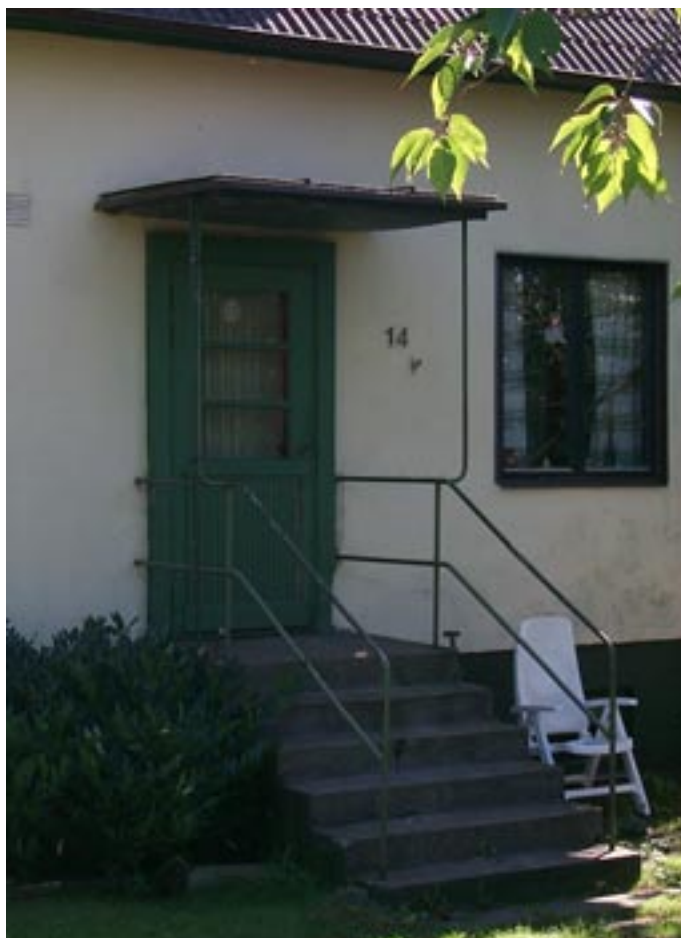
Detaljer är viktiga för hur byggnaden uppfattas. På bilden syns en ursprunglig dörr med ett lätt skärmtak anpassat till byggnadens stil. Det sentida fönstret till höger på bilden har visserligen likheter med det ursprungliga men den mörka färgen avviker starkt från den funktionalistiska byggnadens färger.
